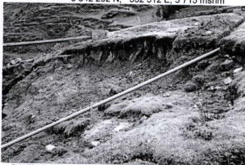
Foto 59 g Ladera con material arcilloso – Santa Ana de Tusi – Nov. 2005
